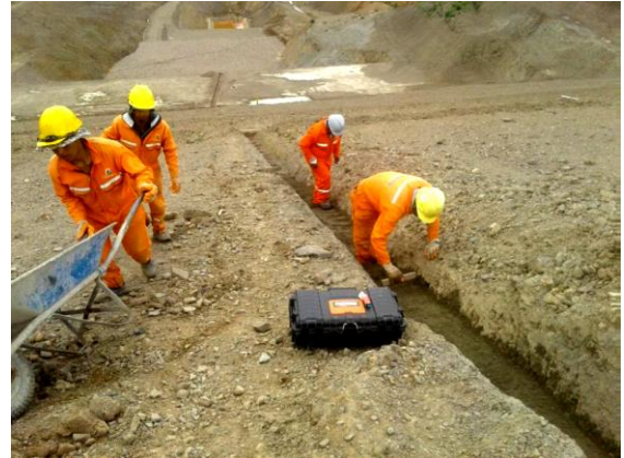
Ejemplo de Aplicación: Monitoreo de Taludes y Diques de Cola en Minera mediante Solución IOT (piezómetros de cuerda vibrante)
